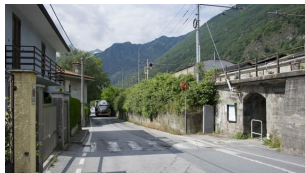
13/06/2014 Il muro che sorregge la ferrovia è pieno di crepe, protestano i residenti di Villa
